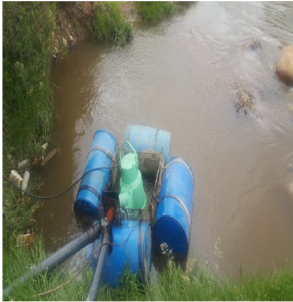
Fotografía 5 Lugar de captación y equipo de captación
