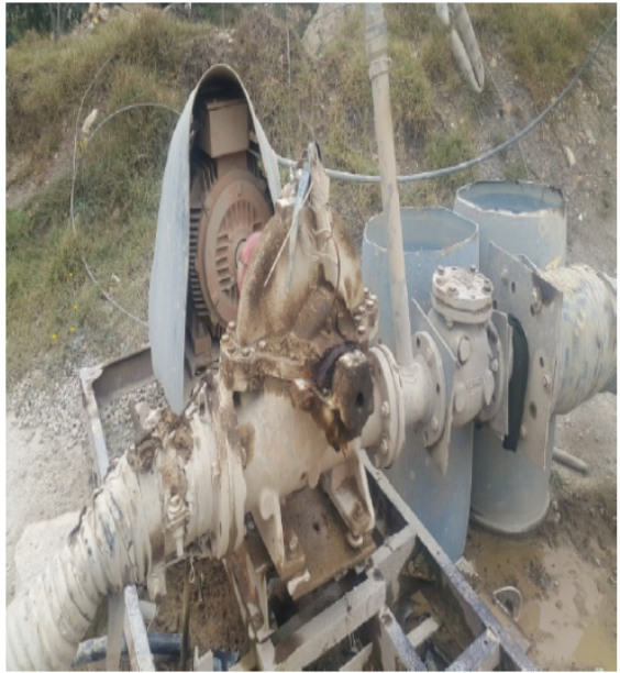
Fotografía 6 Equipo de Bombeo
